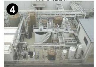
排水処理施設 (公害防止施設)
