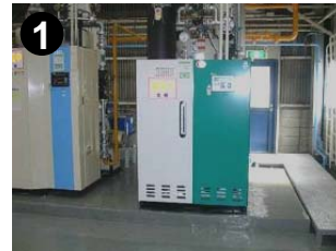
貫流ボイラー
