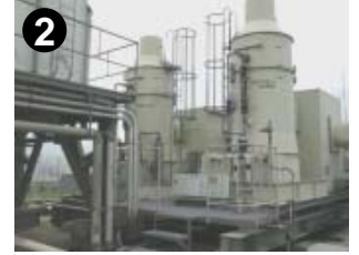
排ガス洗浄装置 (洗浄施設)
